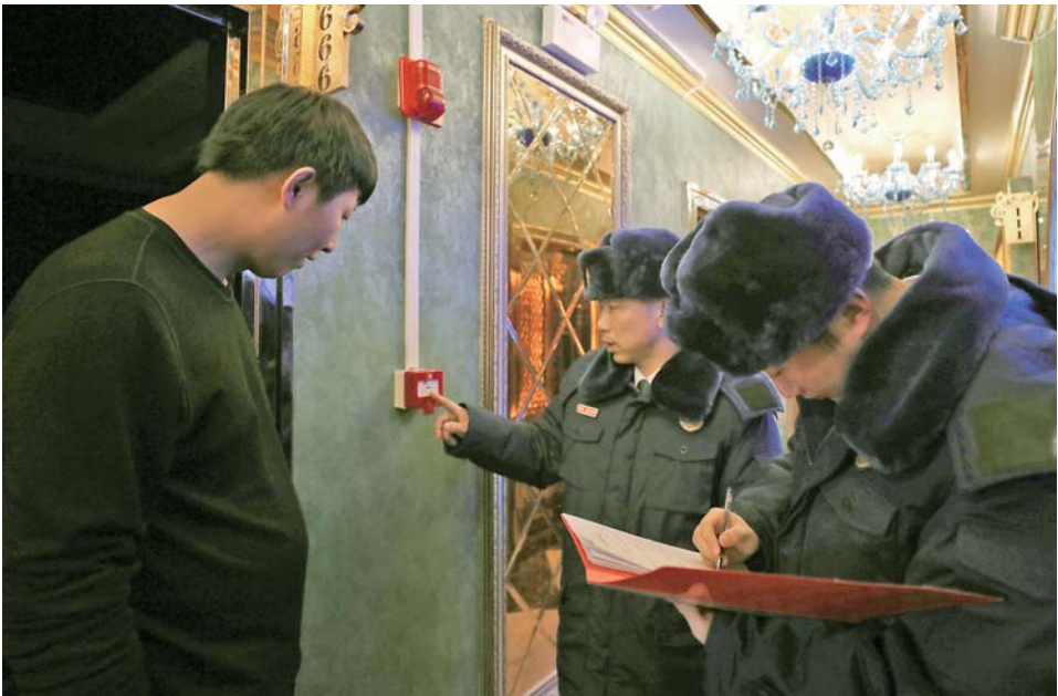
▲2月5日，黑龙江漠河市的消防员们在一家娱乐场所检查消防设施。新华社记者王春雨摄
