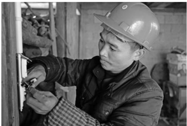
▲2019年1月13日，勤奋的广西融水县乌英苗寨青年杨秀前在安装开关面板。 本报记者谢锐佳摄
