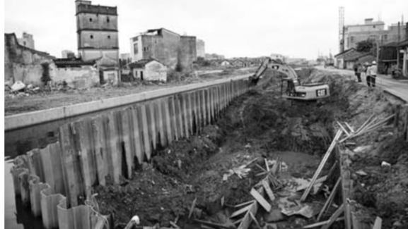
▲工作人员在广东汕头市谷饶镇练江支流进行清淤工作(12月5日摄)。新华社记者邓华摄
