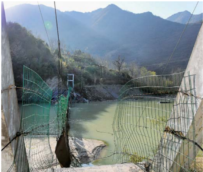
▲11月22日拍摄的被冲毁的江口坝吊桥。
