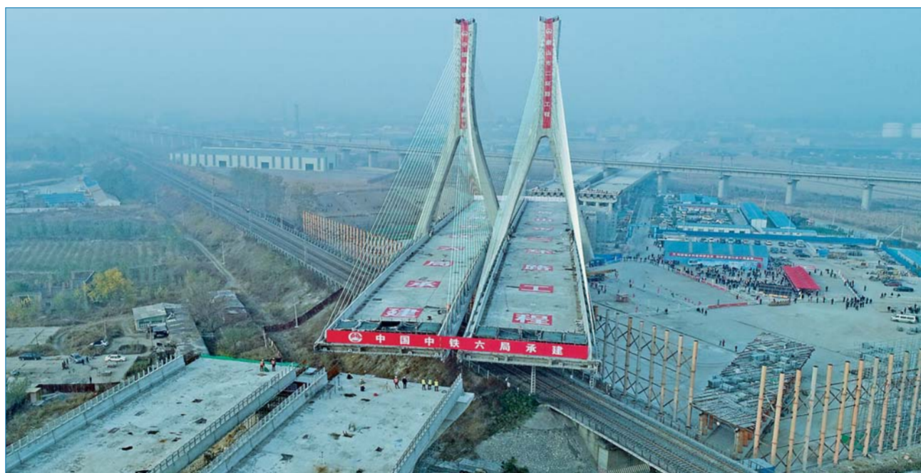
▲唐山市二环路项目上跨津山铁路斜拉桥在转体中(无人机拍摄)。10月25日,河北省唐山市二环路项目上跨津山铁路斜拉桥转体成功。据介绍,该桥总长927.5米,主桥由斜拉转体桥和转体T构桥组成,转体总重5.1万吨,其中斜拉转体桥重3.3万吨,主塔高达80.5米,为曲线变截面“双人字”形空塔,自上而下共有128根斜拉索。新华社记者杨世尧摄
