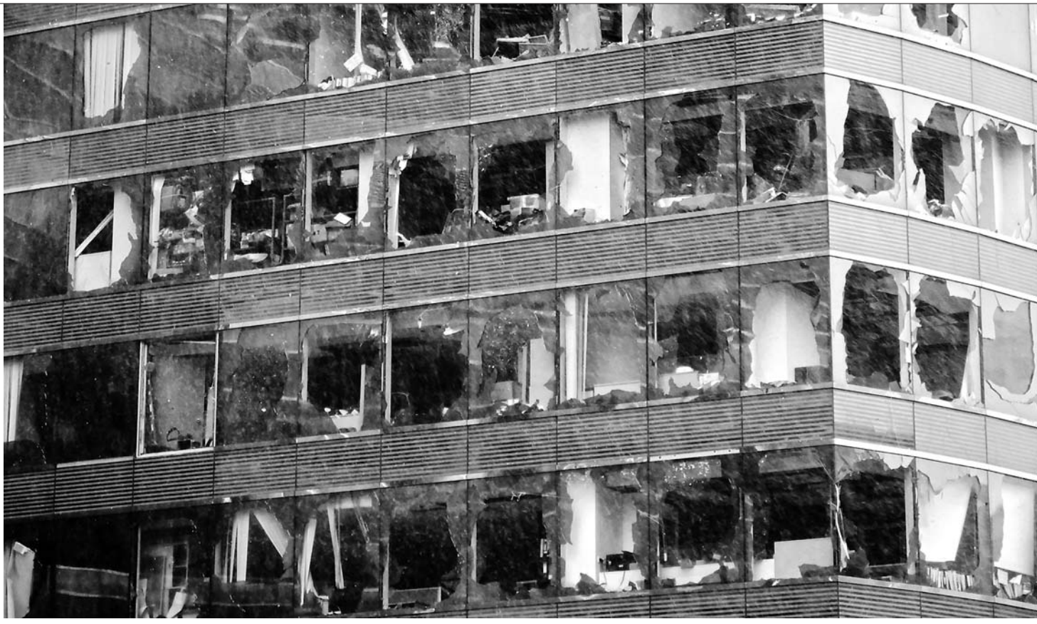
▲9月16日,台风“山竹”袭击香港。图为位于香港九龙半岛红磡海滨的一座写字楼,窗户玻璃破碎严重(9月16日摄)。新华社发(王申摄)
