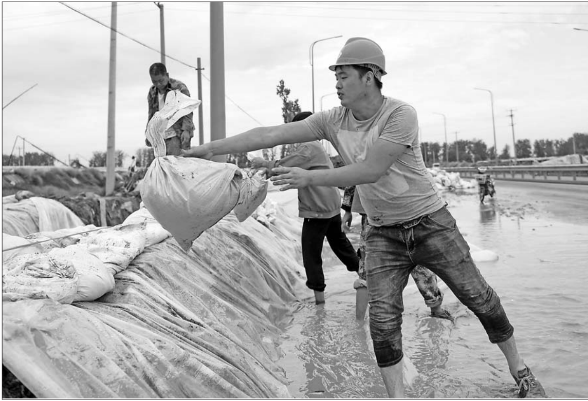
▲八月三十一日,寿光市纪台镇居民在垒筑水渠,加快排水速度。当日,受洪涝灾害影响的山东省寿光市在专业救灾力量的帮助下继续排水作业。目前各受灾乡镇、街道都制订了详细排水计划,通过构筑救灾排水网、错峰有序排水等措施确保内涝区尽快完成排水作业。 新华社记者朱峥摄
