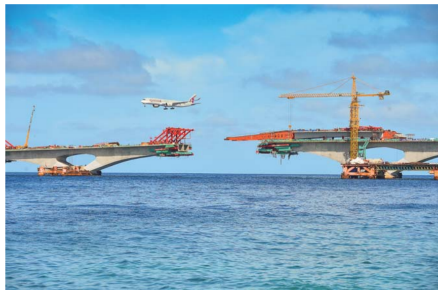
▲2018年6月24日，位于马尔代夫的中马友谊大桥主桥20号墩至21号墩之间的钢箱梁正在顶推。新华社发（杜才良摄）
