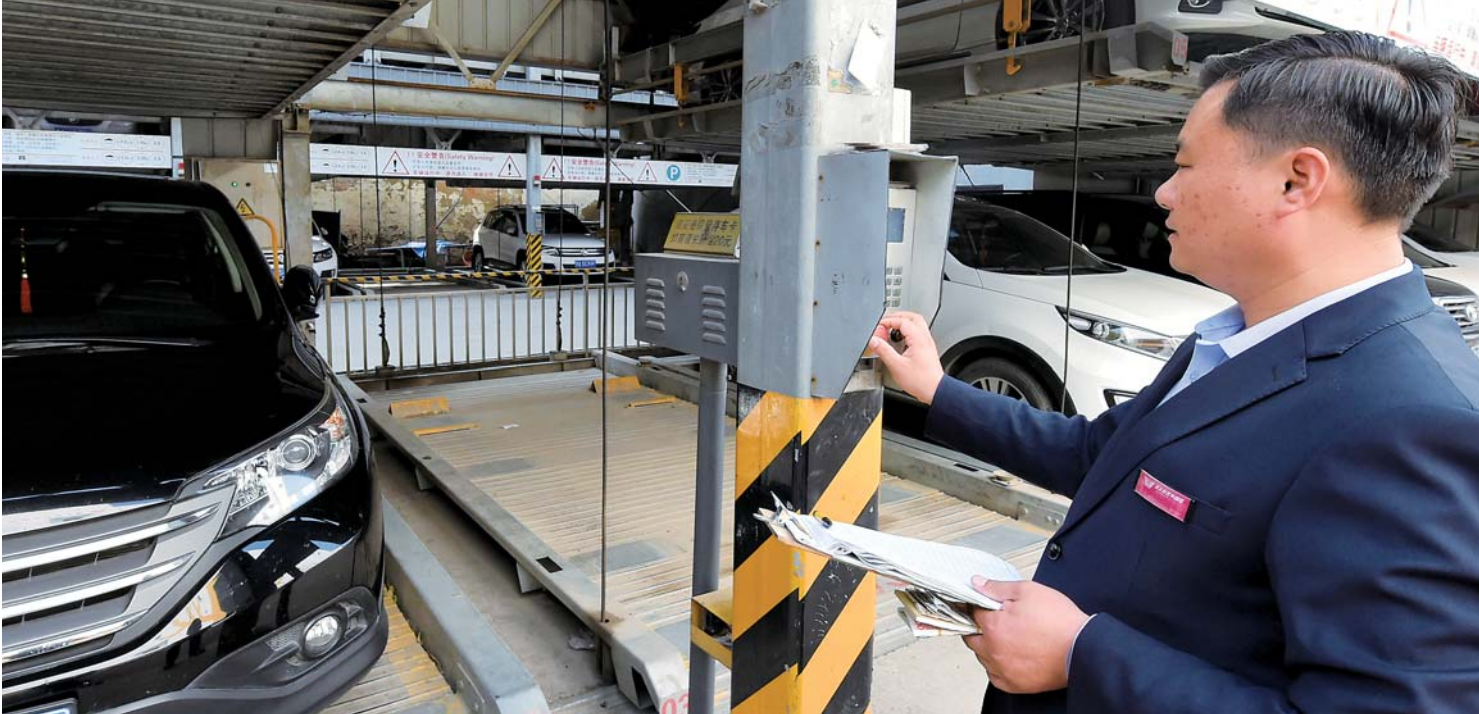
▲ 停车库工作人员正在操作车库系统并将一辆汽车升至上层车库。 新华社记者李嘉南摄
